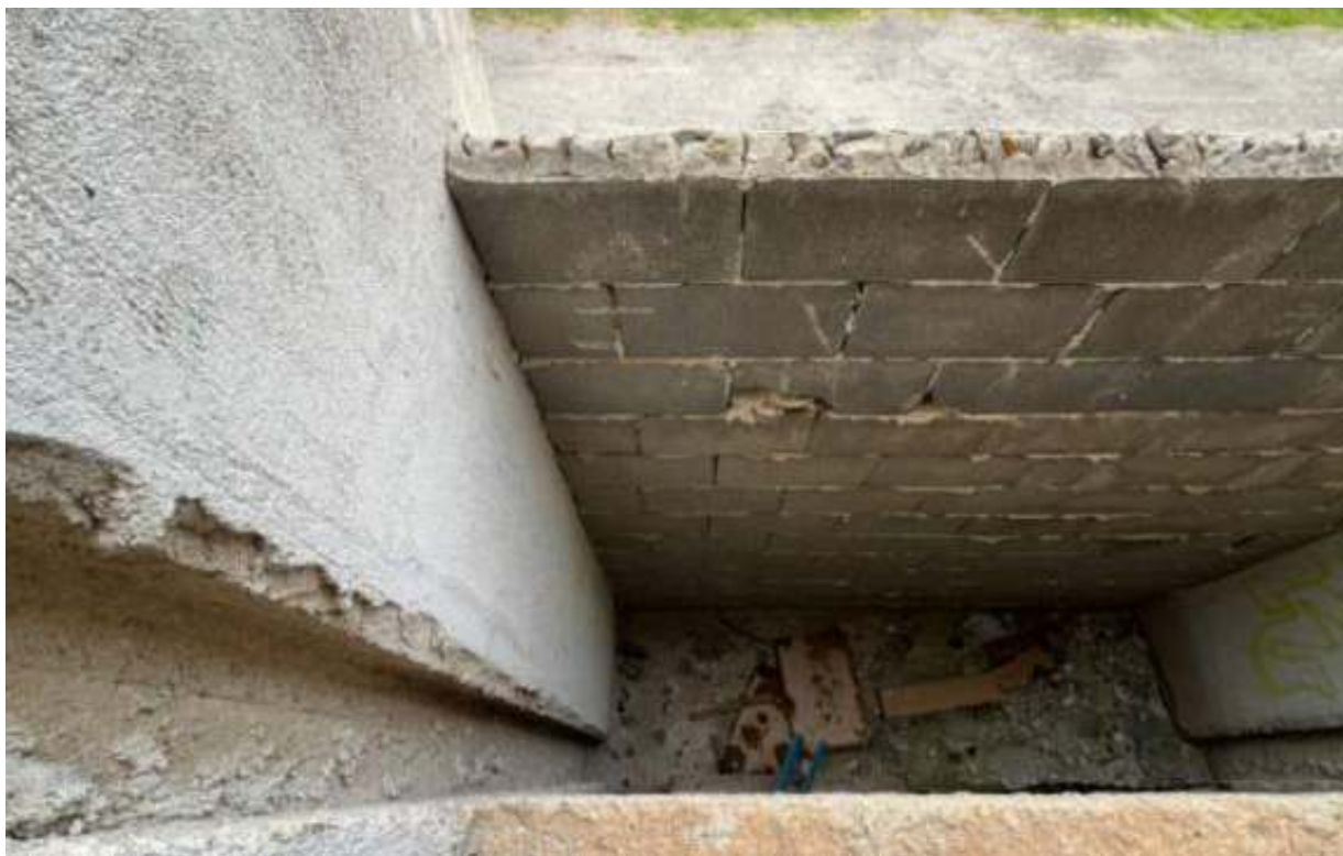
Fig. 3. Palermo, edificio incompiuto di Via Pietratagliata Santa Margherita, chiusura verticale realizzata in autocostruzione (foto dell'autore).
