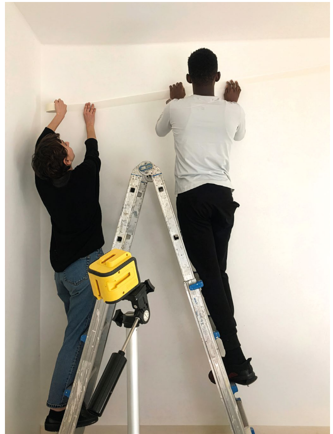
05. Momenti della preparazione della parete prima del co-crafting. L'attività si inserisce in un progetto di micro cantieri di co-design volto al miglioramento degli spazi abitativi dedicati all'accoglienza di giovani richiedenti asilo | Moments from the preparation of the wall prior to the co-crafting activity. The work forms part of a series of micro co-design projects aimed at improving living spaces dedicated to the reception of young asylum seekers. S. Ceraolo
