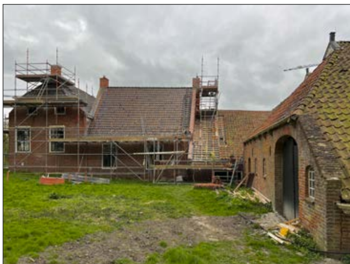
Fig. 3. Trabajos de restauración en Maarhuizen, Groninga (Países Bajos). Fotografía de la autora.
