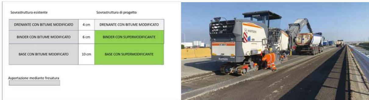
FIGURA 31. A SINISTRA: PAVIMENTAZIONE IN PROGETTO DI TRASFORMAZIONE AUTOSTRADA A4 TORINO-MILANO, A DESTRA: LA FASE DI FRESATURA DEL MANTO STRADALE ESISTENTE PRESSO IL CAMPO PROVE DELL’AUTOSTRADA A4 A OTTOBRE 2022.
