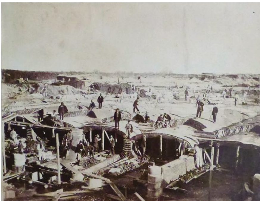
Figura 4: Sifón bajo el río Sesia: la obra [Ministero delle Finanze. Direzione Generale del Demanio. Canale Cavour e Diramatori, Canale Cavour, in Archivio Storico delle Acque e delle Terre Irrigue (Novara)]
