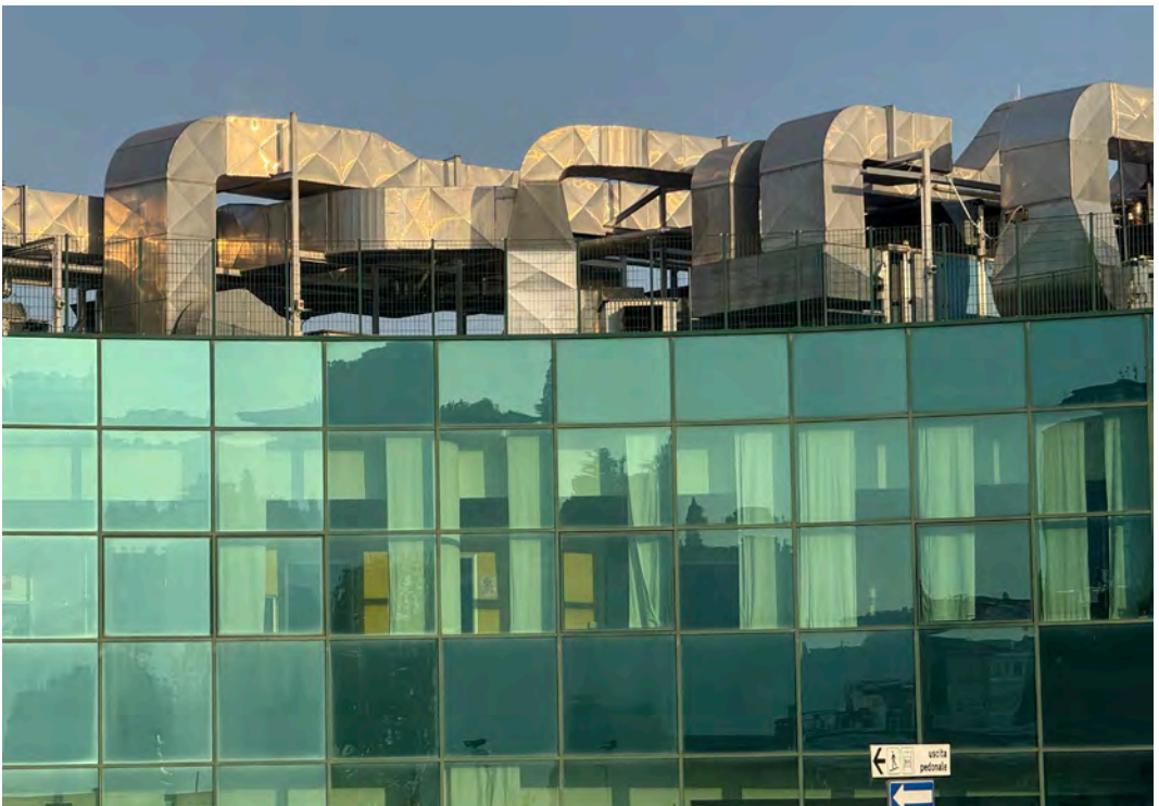
Figg. 2-4 – Accumulazione impiantistica. Crediti: Federica Joe Gardella
