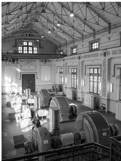
Fig. 05. Centrale idroelettrica Champagne I, Villeneuve (AO), 1921-1929. Centrale attiva. (© E. Vigliocco, 2019)
