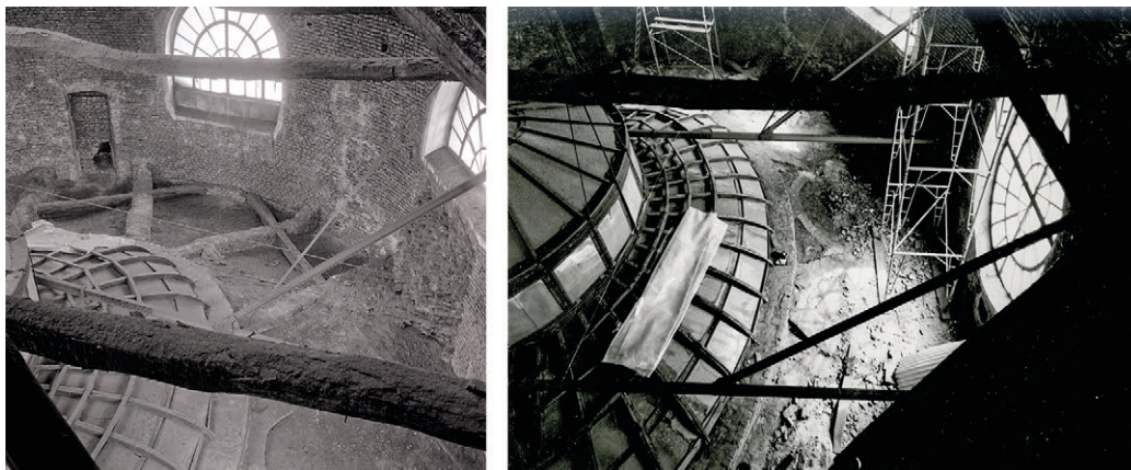
Fig. 4. Stato di conservazione della lanterna prima dei lavori di restauro, c. 1984, Palazzo Carignano (Archivio privato Arch. Andrea Bruno).
