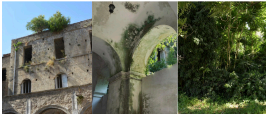
Figura 1 | Rotture, Efflorescenze, Vegetazione – Ex Ospedale psichiatrico La Maddalena, Aversa. Fonte: Foto di Lucia Ludovici e Ilaria Maurelli.
