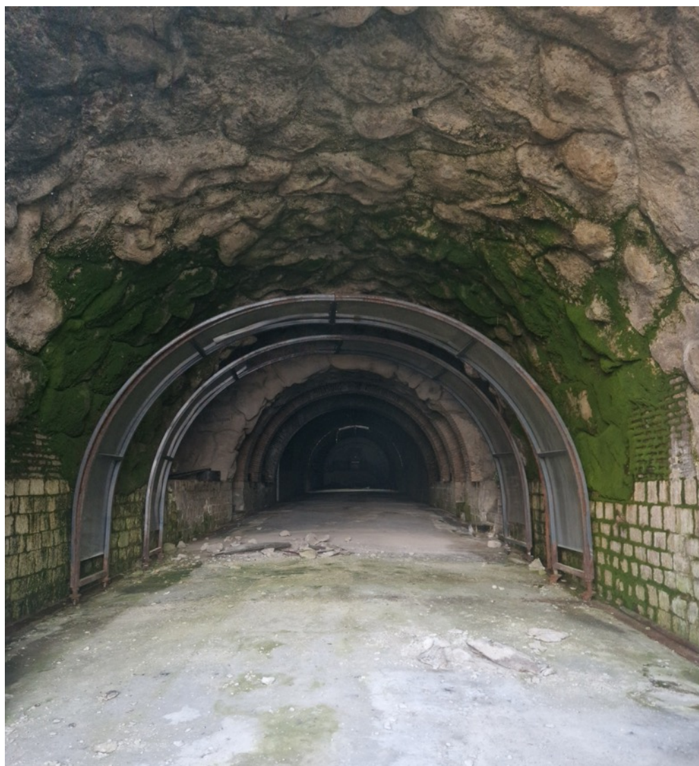
2: Il Covo degli Arditi in stato di completo abbandono. Sono ancora visibili le impalcature metalliche installate nel 2001 per l'apertura al pubblico come spazio espositivo. Agosto 2023, foto dell'autrice.
