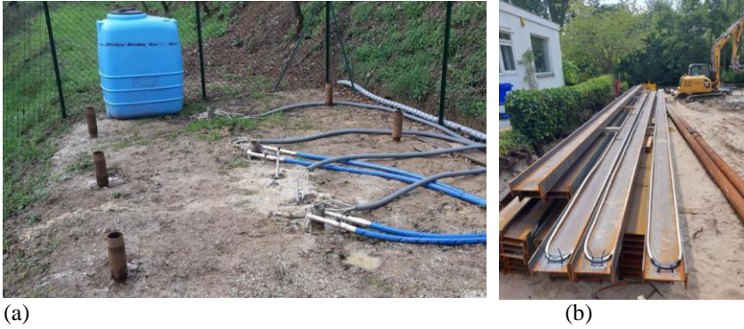
Figura 1. Esempio di (a) micropali energetici presso l'Università di Perugia (Ronchi et al. 2018), (b) applicazione di diaframmi CSM energetici ad Amstelveen (Leclercq et al., 2023, Gerola et al., 2024b).
