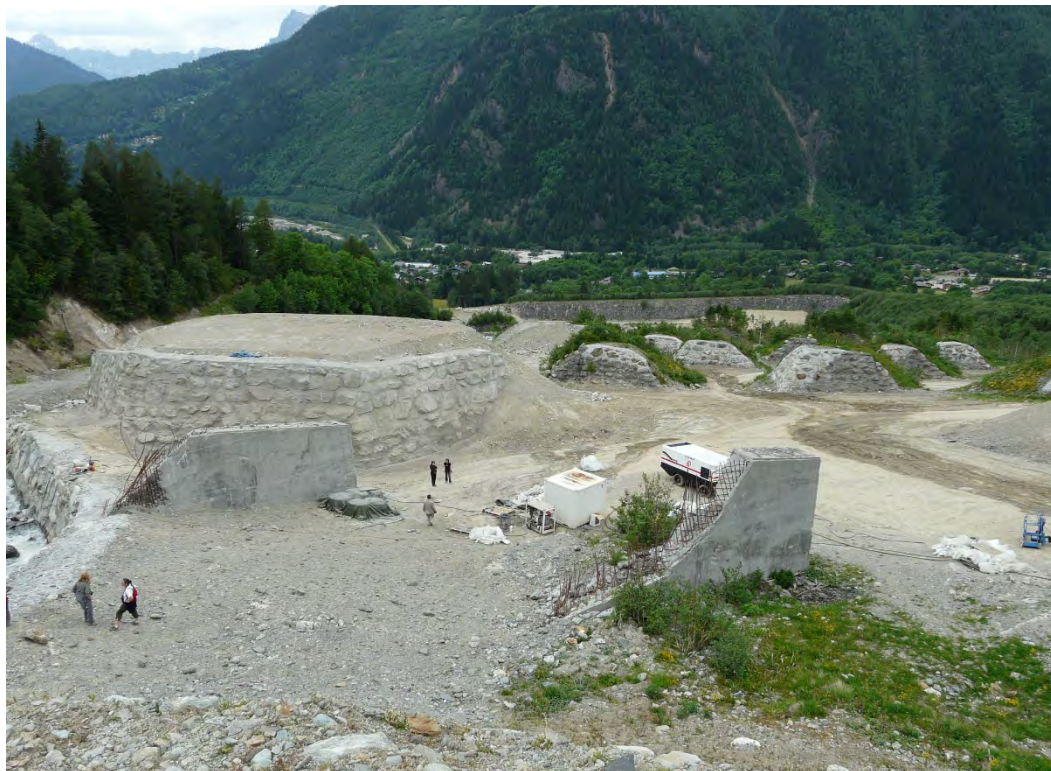
Figura 4.6 - Cumuli e cunei frenanti presso il bacino valanghivo a valle del ghiacciaio di Tacconaz - Monte Bianco (FR). Sullo sfondo la diga di contenimento. In primo piano due denti di rallentamento in cemento armato distrutti dall'evento valanghivo (Frigo, 2009).
