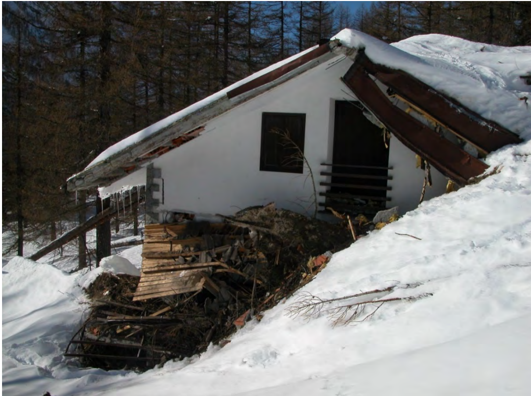
Figura 2.6 - Danneggiamento di un edificio. Sono evidenti i danni alla copertura, alle sue parti sporgenti e il deposito valanghivo sulla falda di monte. Ceresole Reale, Piemonte (Chiambretti, 2009).
