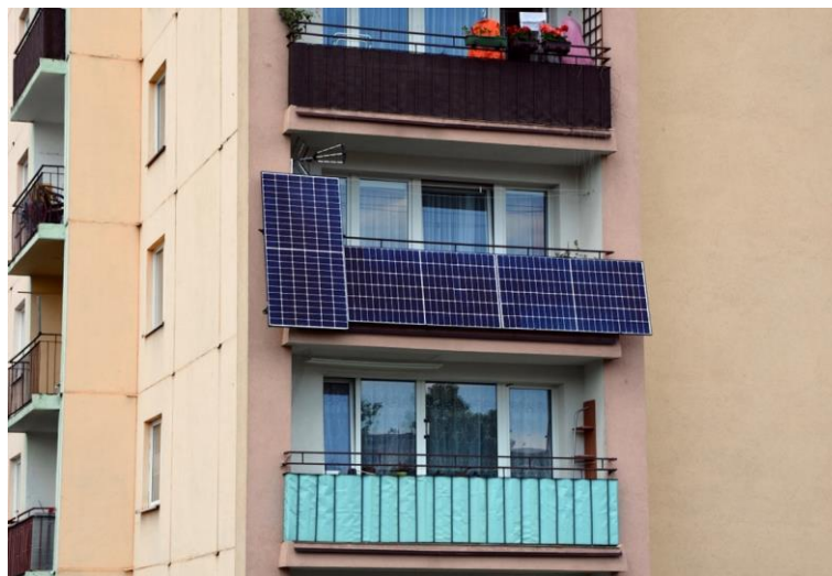
Fig. 2. Visual interference of balcony photovoltaic kits © 2022 https://progetti.habitissimo.it/progetto/consigli-per-posizionare-il-fotovoltaico-sul-balcone-di-casa
