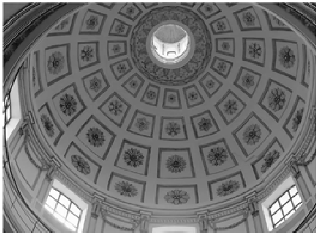
In alto: Quadro fessurativo facciata laterale e cupola (el. Nardisarchitetti, L'Aquila). In basso: Cupola dopo i lavori di restauro nel 2018 (è visibile, in maniera quasi impercettibile, la linea di crollo in sottosquadro (ph. G. Mastrangelo 2019).
