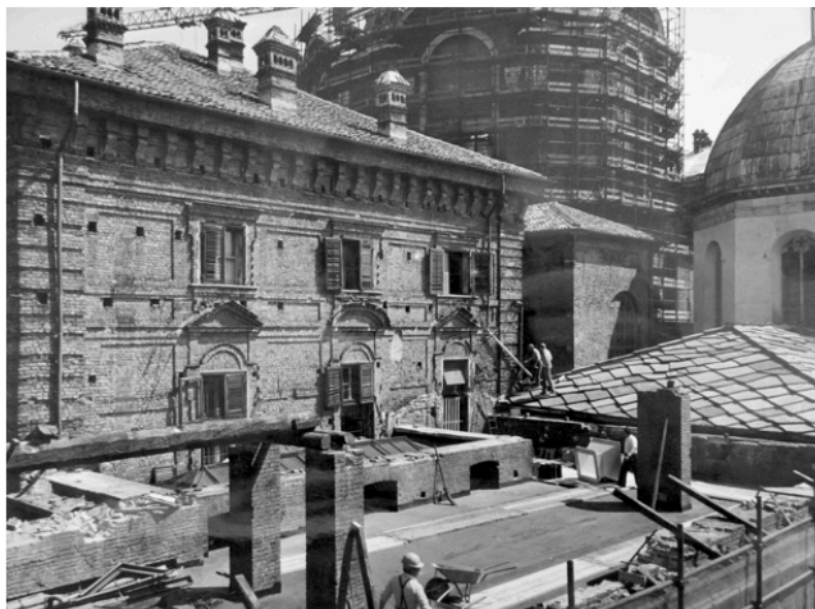
Figura 5. Torino, Palazzo Reale – Manica Nuova, intervento di smantellamento della copertura addossata a Palazzo Reale e al Duomo (SABAP-TO, SBAP-PIE, Torino: Palazzo Reale – Manica Nuova , TO/582/8. Sun concessione del MIC).
