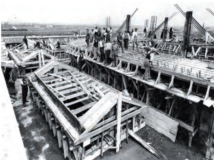
Fig. 4 Stabilimento Fiat Lingotto, Torino. Costruzione di edifici complementari 1925. Fiat Lingotto plant, Turin. Construction of additional buildings, 1925. (© ASF Archivio Storico Fiat)
