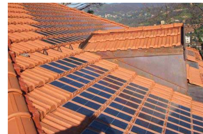
Copertura con tegole fotovoltaiche da: https://www.ecorisoluzioni.org
