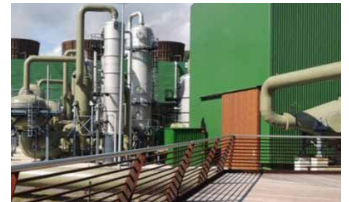
Centrale geotermica di Triana sul monte Amiata, Toscana IT da https://www.cosvig.it
