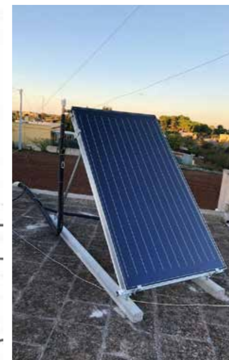
Solare termico su tetto piano da: https://www.thermobasil.it
