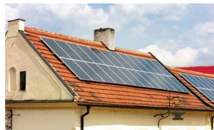
Pannelli solari da https://www.edilportale.com
