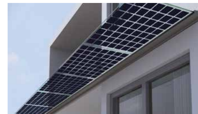
Brise soleil fotovoltaico da: https://www.balconefotovoltaico.it
