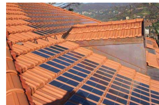
Copertura con tegole fotovoltaiche da: https://www.ecorisoluzioni.org
