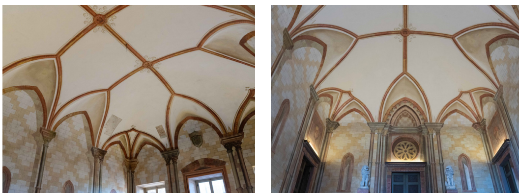
Fig. 16: La volta a botte con teste di padiglione dello Scalone. Fotografie: F. Natta
