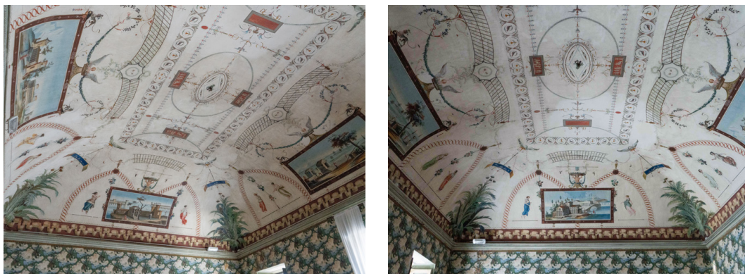
Fig. 18: La volta a botte con teste di padiglione della Sala dei paesaggi. Fotografie: F. Natta
