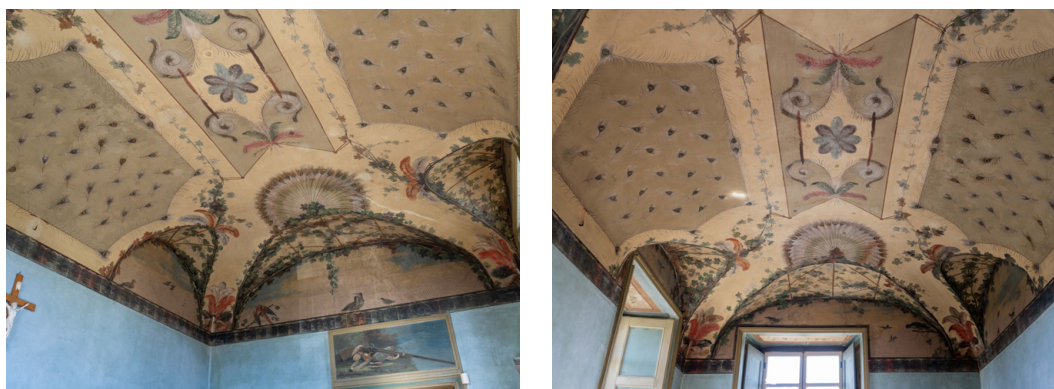
Fig. 35: La volta a botte con teste di padiglione lunettata della Saletta della caccia. Fotografie: F. Natta
