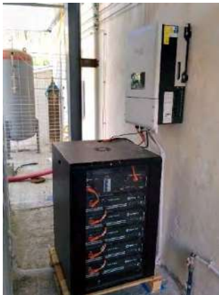
b) inverter e batterie di accumulo
