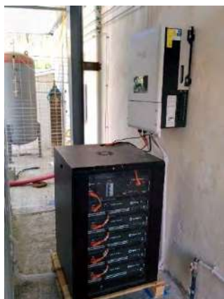
b) inverter e batterie di accumulo
