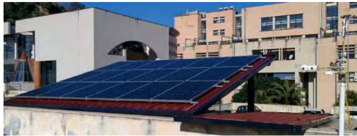
a) pannelli fotovoltaici
