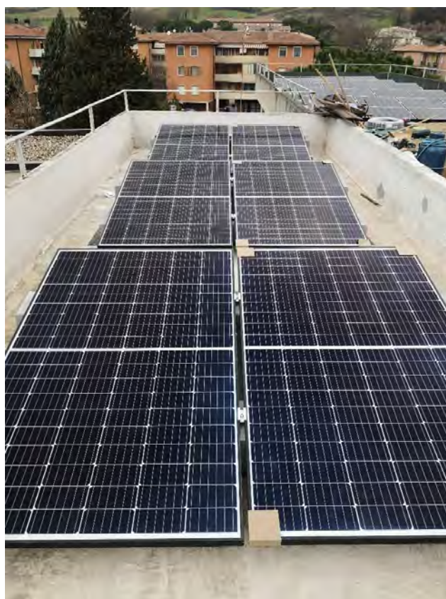
Figura 9. Impianto fotovoltaico installato (vista 2)
