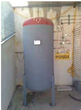
d) serbatoio di accumulo idrogeno
