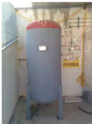
d) serbatoio di accumulo idrogeno
