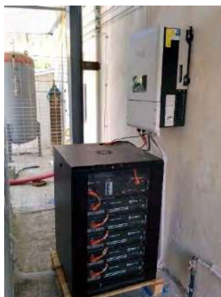
b) inverter e batterie di accumulo
