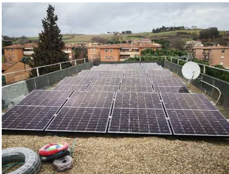
Figura 8: Impianto fotovoltaico installato (vista 1)
