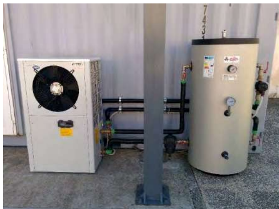
e) chiller e accumulo acqua tecnica
