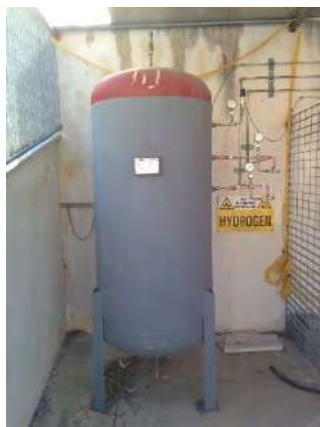
d) serbatoio di accumulo idrogeno
