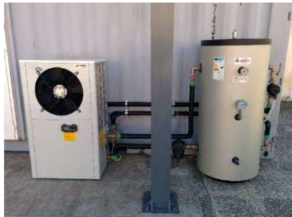
e) chiller e accumulo acqua tecnica
