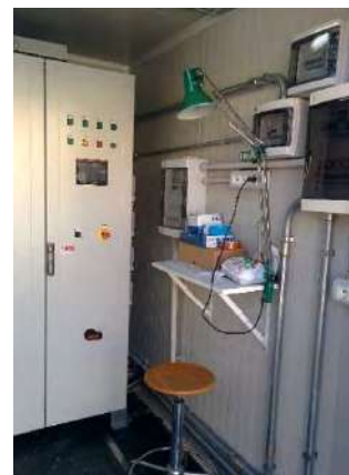
h) PLC – pannello di controllo
