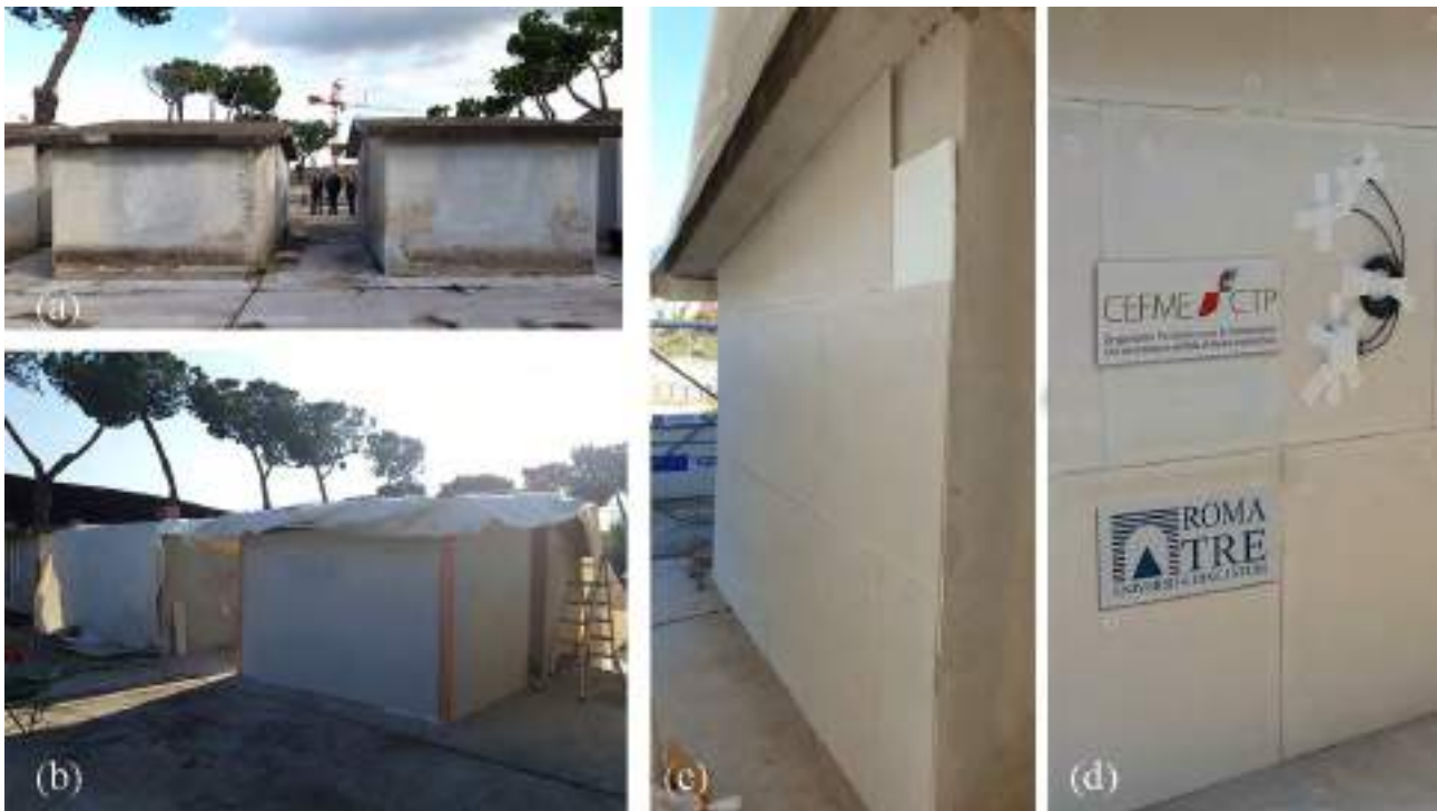
Figura 3. Immagine degli edifici analizzati (a), del caso studio (b), del sistema a cappotto in fase di installazione (c) e ad installazione terminata (d).
