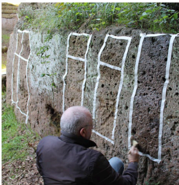
Fig. 3 Cerveteri, Via degli Inferi, l'applicazione dei formulati protettivi sulla parete di una tomba (Foto T. Vagnarelli 2020)
