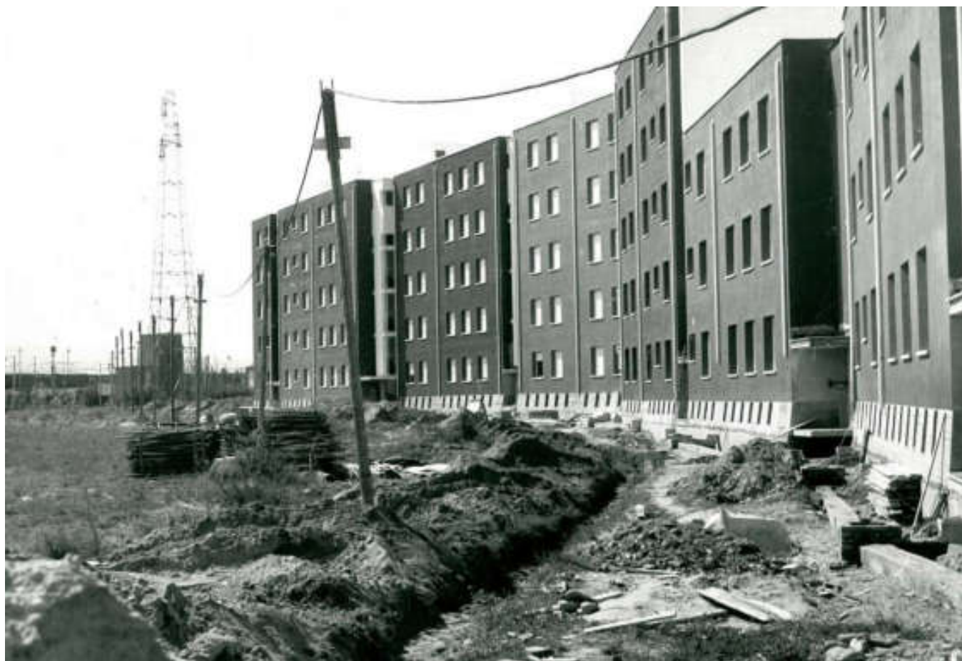
Fig. 6 Cantiere dell'edificio di Glauco Gresleri al Pilastrò, 1965. Archivio privato di Glauco Gresleri.
