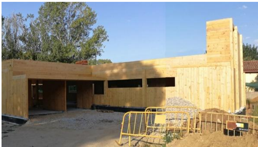
Centro medico di Cap di Riells (Spagna), struttura portante prefabbricata in cross-lam (CLT).
