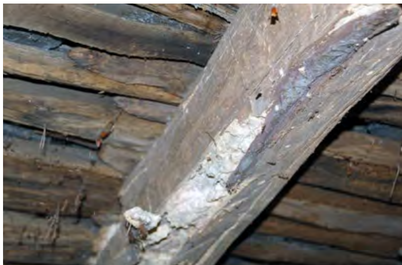
Figura 5 Travatura principale vistosamente attaccata da insetti xilofagi e funghi di caria bianca. La capacità strutturale di resistenza risulta compromessa.
