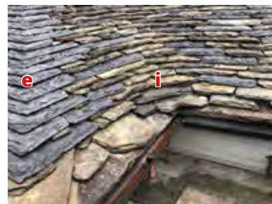
Figura 47 Manto con impluvio (i) tondo ed espluvio (e) angolare. Cappella di Abramo - Sacro Monte di Ghiffa. Arch. Scotton.
