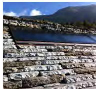
Figura 59 Pannelli integrati in falda sotto colmo. Casa Gatti - Varzo. Arch. Scotton/Saegesser.
