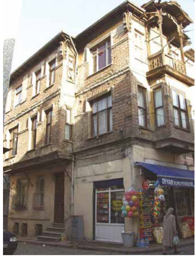
Fotoğraf 5 - 2307 ada 28 parseldeki yapının restorasyon öncesindeki durumu (Kaynak: www.fenerbalat.org) / The before-restoration situation of the building on the building block 2307 the building lot 28 (Source: www.fenerbalat.org)
