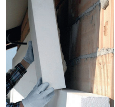
Posa di pannelli in EPS per la realizzazione di un cappotto termico da https://www.azichem.it/prodotti/rascoat/125/
