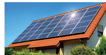
Impianto fotovoltaico da https://efficasa.it/blog/fotovoltaico-e-storage/impianto-fotovoltaico-ai-sola-come-funziona-e-perche-conviene
