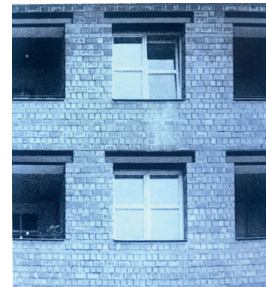
Aldo Rossi, complesso residenziale, Berlino, 1985. Gli architravi sono in acciaio da Campioli A., Lavagna M. (2013), Tecniche e architettura , Città studi
