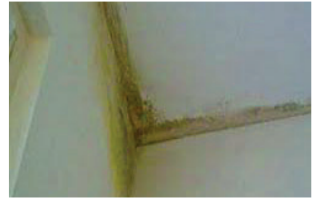
Muffe e batteri visibili a causa di un ponte termico da https://www.bioisotherm.it
