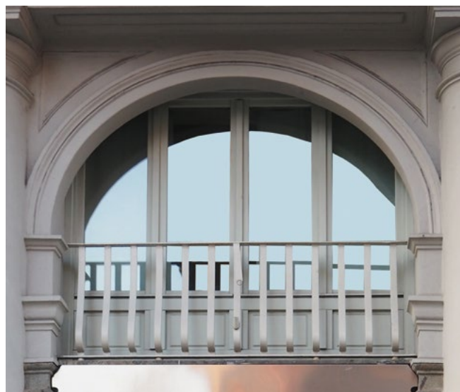
Figura 14. Una parte dello stesso edificio, sottoposto a manutenzione straordinaria: sostituzione degli infissi; arretramento dell'infisso, con modifica della conformazione geometrica per semplificare la realizzazione di vetri-camera a tutta luce in formato rettangolare; rifacimento della protezione alle cadute per tutta la luce dell'apertura. Manutenzione trasformista: eliminati elementi costruttivi originali di Antonelli. Già Franco Rosso aveva previsto il rischio della trasformazione con interventi non adeguati al mantenimento del progetto originale.
