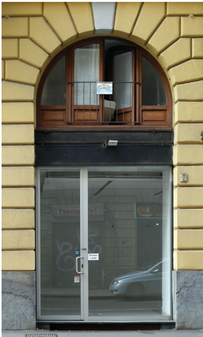
Figura 12. Casa Antonelli, via Vanchiglia (foto di Gianfranco Cavaglià, novembre 2020). Protezione da cadute, ringhiera in corrispondenza delle sole parti apribili: un elemento costruttivo di Antonelli. L'infisso al piano terra sostituito con infisso metallico: mancano strumenti per vincolare il mantenimento di quelli originali.
