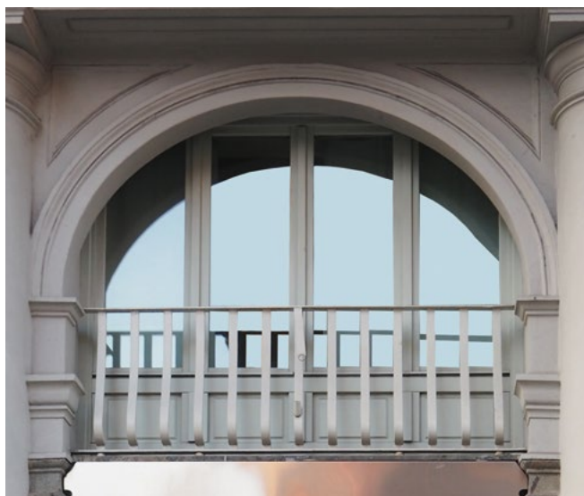
Figura 14. Una parte dello stesso edificio, sottoposto a manutenzione straordinaria: sostituzione degli infissi; arretramento dell'infisso, con modifica della conformazione geometrica per semplificare la realizzazione di vetri-camera a tutta luce in formato rettangolare; rifacimento della protezione alle cadute per tutta la luce dell'apertura. Manutenzione trasformista: eliminati elementi costruttivi originali di Antonelli. Già Franco Rosso aveva previsto il rischio della trasformazione con interventi non adeguati al mantenimento del progetto originale.
