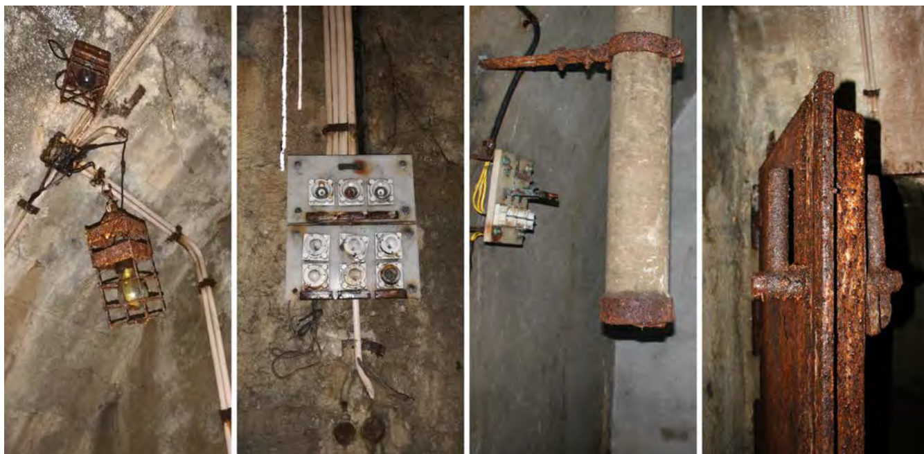
5: Alcuni dettagli dei dispositivi che è ancora possibile apprezzare all'interno del rifugio. Da sinistra: gabbia metallica contenente una lampadina, quadro elettrico, tubatura di areazione, porta blindata (foto degli autori).
