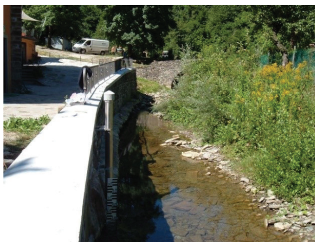
Fig. 13 - Stazione di misura del deflusso di un torrente, a valle del tratto soggetto alla possibile interferenza con opere sotterranee.
