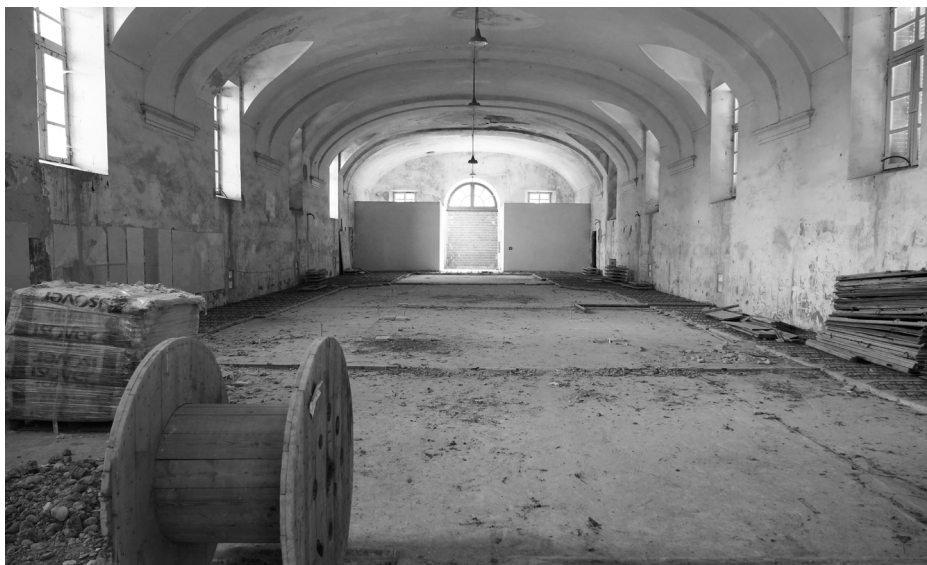
sopra: interno del piano terreno dove le stanze sono incompiute e inutilizzabili; sotto, stato di conservazione degli edifici / / above, interior of the ground floor where the rooms are unfinished and unusable; below, the state of conservation of the buildings
