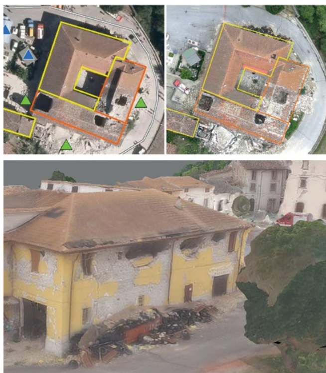
Figura 15. Accumoli, BDA di un edificio campione. In alto a sinistra la grading map di Copernicus, a destra la stessa mappa sovrapposta all'ortofoto da UAVs. In basso una vista dei danni ai fronti dell'edificio individuati sul modello 3D derivato da UAVs.
