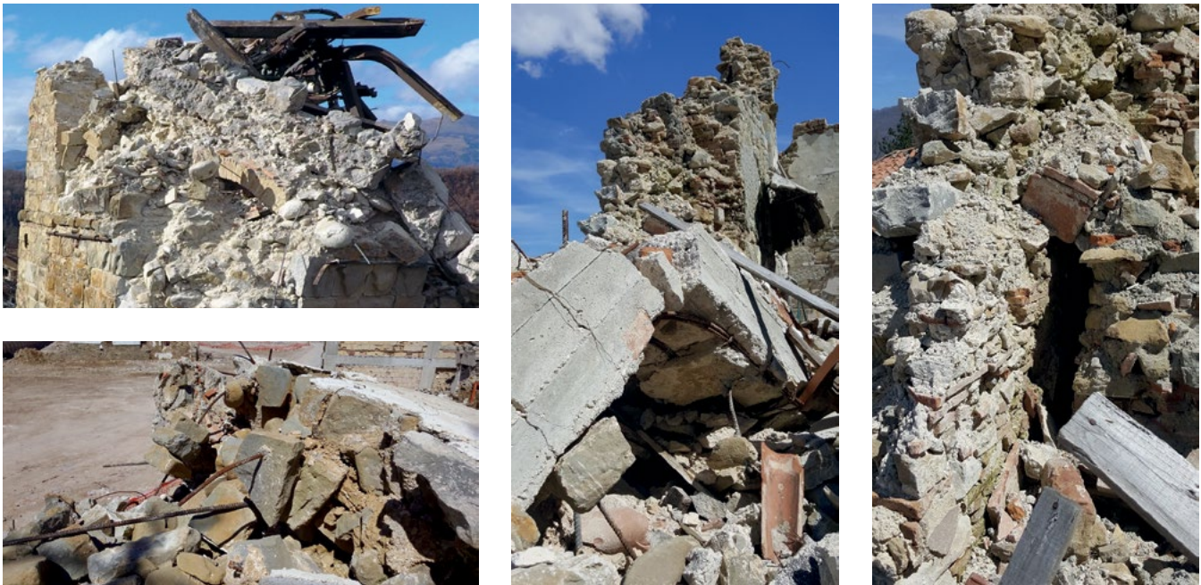
Figura 10. (a) Cella campanaria crollata: sono visibili i tiranti originali e le armature del cordolo in cemento armato inserite durante il consolidamento degli anni '80. (b) Cordolo in cemento armato eseguito efficacemente mediante barre verticali molto lunghe. (c-d) Vulnerabilità insite nella muratura di base, costituita da una sovrapposizione di strati edificatori.
