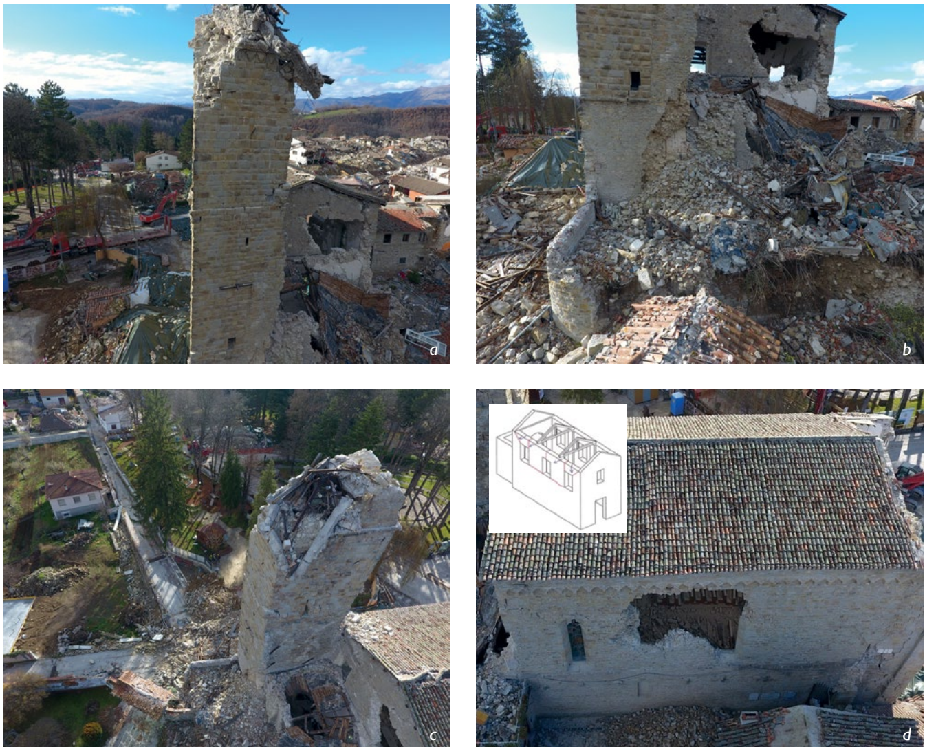
Figura 7. Una sequenza di immagini da UAV dopo l'evento del 30 ottobre 2016. (a) effetti sul campanile e sulle murature della chiesa; (b) murature di differente tessitura alla base del campanile; (c) danneggiamento e crollo parziale del cordolo di cemento armato inserito per legare superiormente la cella campanaria; (d) muratura del fronte ovest crollato, in una vista ingrandita.
