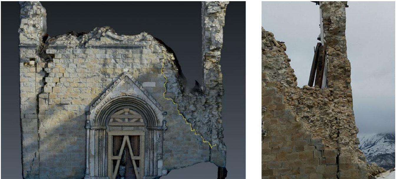
Figura 19. Particolare della struttura in muratura multistrato e la mancanza di connessione tra le murature del fronte principale e quelle ortogonali, osservabili sul modello T2 (dopo l'evento di ottobre) e tramite foto.
