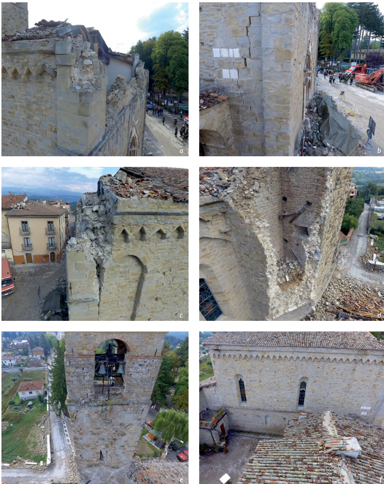
Figura 6. Una sequenza di immagini da UAV acquisite dal gruppo SAPR dei Vigili del Fuoco dopo il 24 agosto 2016. (a) muratura danneggiata in prossimità dell'intervento di inserimento del rosone in facciata, caratterizzata da una elevata vulnerabilità; (b-c) effetto del ribaltamento della facciata, visto da entrambi i lati; (d) Arco "Carbonara" completamente crollato, caratterizzato da murature solo sovrapposte e non ammassate alla parete della chiesa; (e) il fronte ovest della torre campanaria, non molto visibile dal basso, presenta lesioni evidenti già dopo la prima forte scossa, sicuramente di entità più ingente rispetto agli altri fronti; (f) fronte ovest, presenta fessurazioni evidenti soprattutto nella parte absidale della chiesa.
