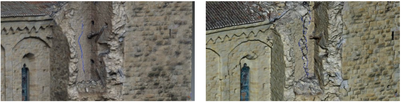
Figura 11. Modello metrico strutturato 3D misurabile che mostra la fessura dell'arco Carbonara: (a) stato di settembre 2016, (b) stato di dicembre 2016, fessure di 20-70 cm.
