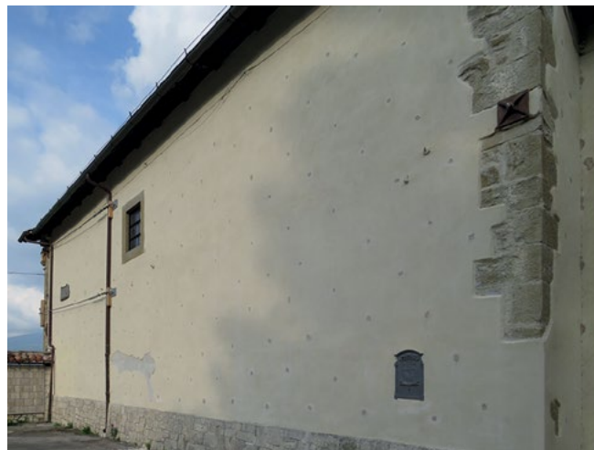
Figura 2. Prospetto nord-ovest della chiesa. Sono visibili i punti delle iniezioni e, sulla destra, il capochiave del nuovo tirante incluso nelle opere di messa in sicurezza per rinforzare l'arco dell'abside.
