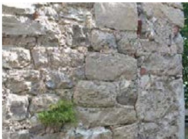
fig. 22 – Parete sud della cappella. Linea di accostamento delle due murature di epoche diverse.
