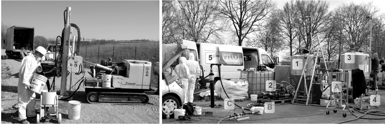
Fig. 4. A sinistra: iniezione di nZVI tramite direct push; a destra: iniezione di nZVI tramite permeazione, (1) contenitore per la preparazione delle sospensioni, (2) unità di dispersione e ricircolo, (3) contenitore per lo stoccaggio delle sospensioni, (4) pompa d'iniezione, (5) pozzo d'iniezione, (A) misuratore di portata, (B) misuratore di suscettività magnetica, (C) misuratore di pressione.
