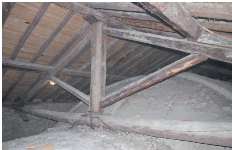
FIG. 3 Borno, Chiesa di San Giovanni Battista: vista di una capriata con il sistema di tiranti metallici inclinati Borno, St. John Baptist's Church: view of a roof truss with the inclined iron tie-rods
