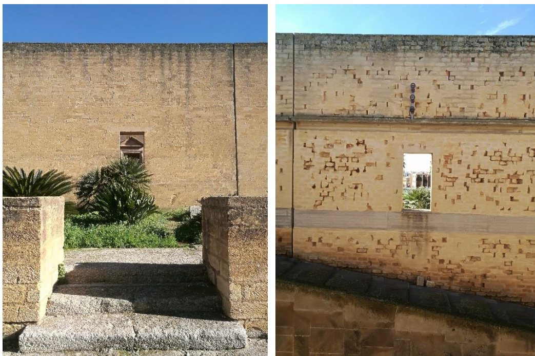
Figura 2.88 – Gibellina Nuova. Palazzo Di Lorenzo. Oggi. Particolari. Oggi la “macchina” ottica progettata dall’arch. Francesco Venezia è in un certo senso annullata dalla presenza di vegetazione che ne oblitera la visuale. Fonte: Foto dell’autrice, 2017.
