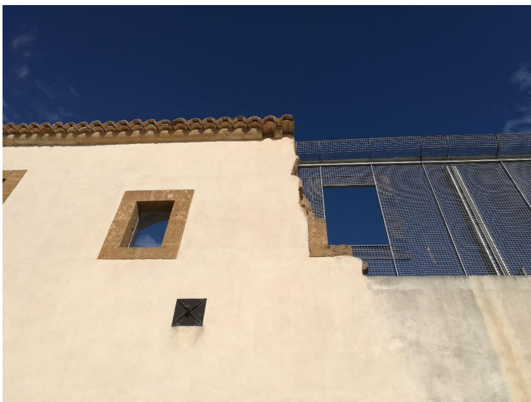
Figura 2.123 – Ruderì di Salaparuta. Ex Convento dei Cappuccini. Il grigliato strutturale riconfigura i volumi e completa il disegno di facciata per linee semplificate degli elementi architettonici parzialmente sopravvissuti. Fonte: Foto dell'autrice, 2017.
