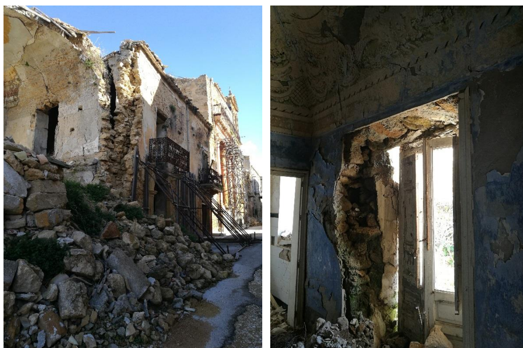
Figura 2.11 – Ruedi di Poggioreale. Le immagini evidenziano le caratteristiche delle murature in blocchi di tufo che potevano essere del tipo "a sacco" con riempimento di pietrame. Fonte: Foto dell'autrice, 2017.
