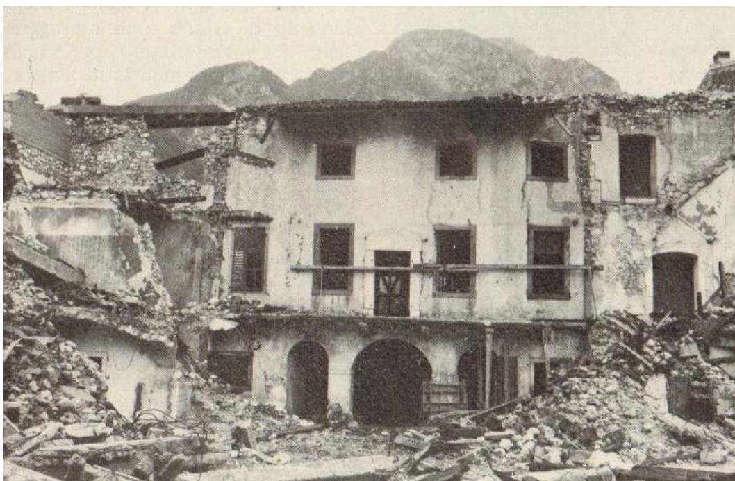
Figura 2.172 - Venzone. Palazzo Orgnani-Martina post sisma. Il terremoto del 6 maggio provocò il crollo delle ali del complesso restaurate nel dopoguerra. Fonte: Bollettino “Amici di Venzone” V, 1976, 97.
