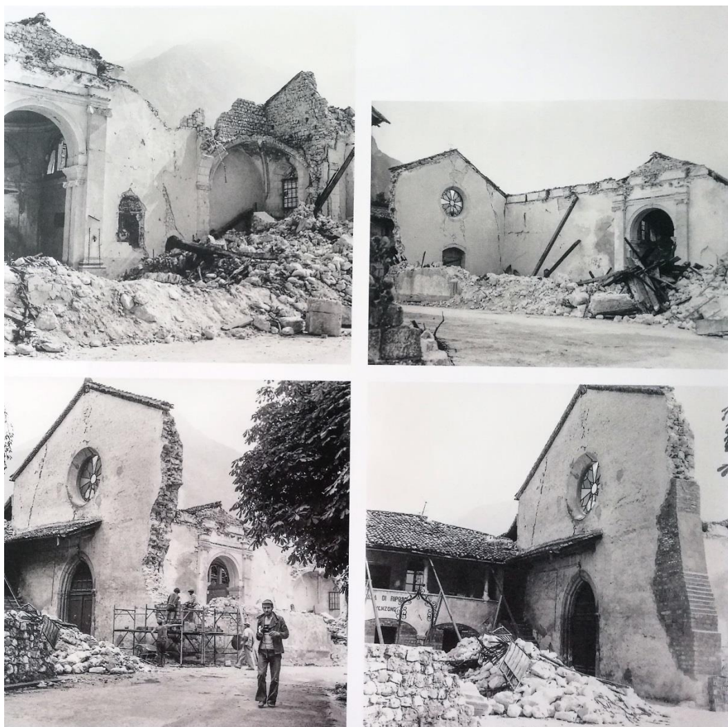
Figura 2.193 - Venzone. Chiesa di S. Giovanni Battista post 1976. I sismi del 1976 causarono il crollo dell'edificio, poi prontamente consolidato nelle porzioni superstiti. Fonte: Marino, 2014, 274.
