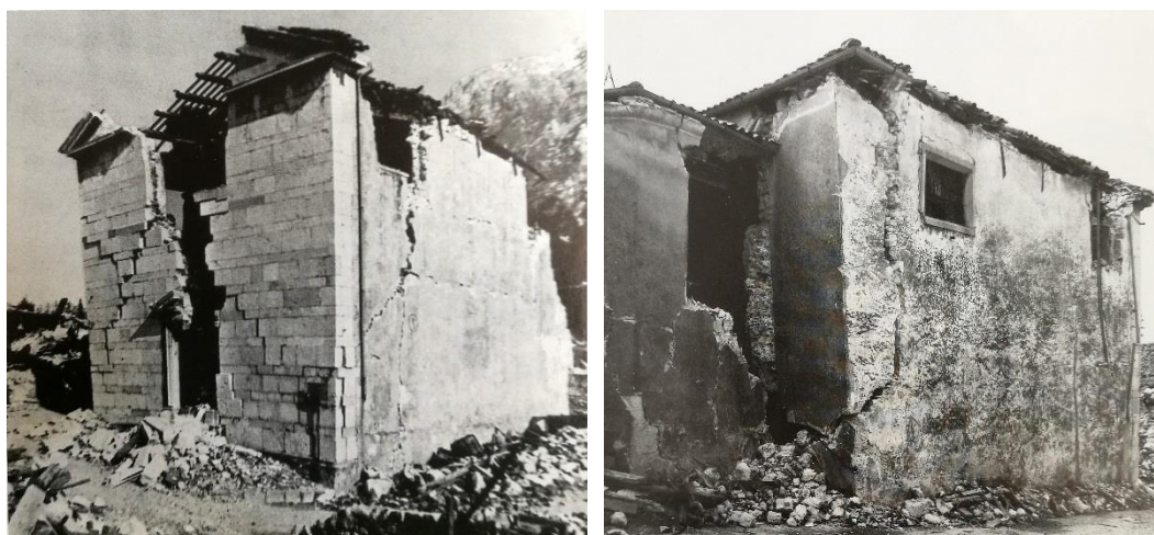
Figura 2.236 - Gemona del Friuli. Chiesa di S. Maria di Fossale post sisma. Le scosse del 15 settembre 1976 provocarono crolli parziali della facciata e la diffusione delle lesioni sull'intera chiesa. Fonte: Bellina, 1986, 105, 106.
