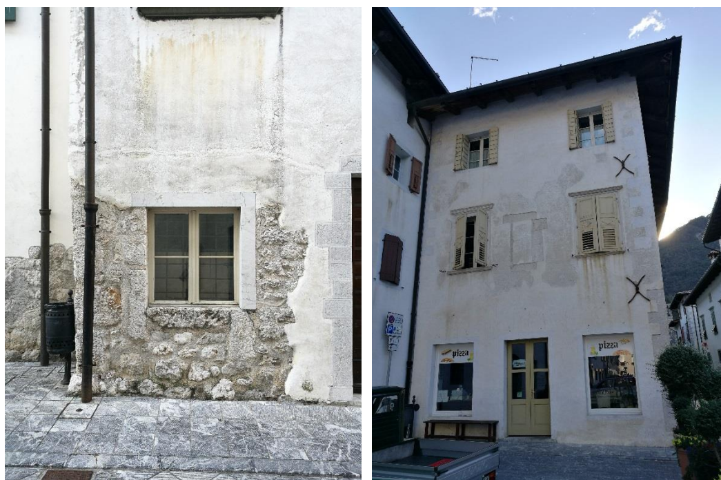
Figura 2.164 – Venzone. Scorci sulle vie del centro. Oggi. Gli edifici ricostruiti mostrano i segni dei consolidamenti e delle reintegrazioni subite a seguito dei danni provocati dai sismi. Fonte: Foto dell'autrice, 2017.
