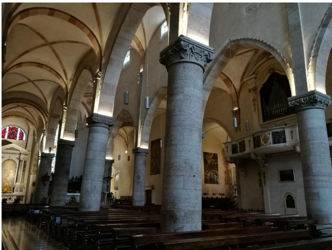
Figura 2.245 – Gemona del Friuli. Duomo. Oggi. Interno. Il sisma provocò il crollo della navata destra e della porzione absidale, che furono ricostruite lasciando memoria del meccanismo di collasso attraverso la conservazione dell'inclinazione delle colonne. Fonte: Foto dell'autrice, 2017.
