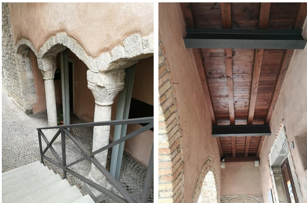
Figura 2.216 - Gemona del Friuli. Casa Gurisatti. Oggi. Particolari. Le strutture del Palazzo sono state ricostruite e consolidate con telai di acciaio a vista, denunciando quindi gli interventi realizzati sulla preesistenza. Fonte: Foto dell'autrice, 2017.
