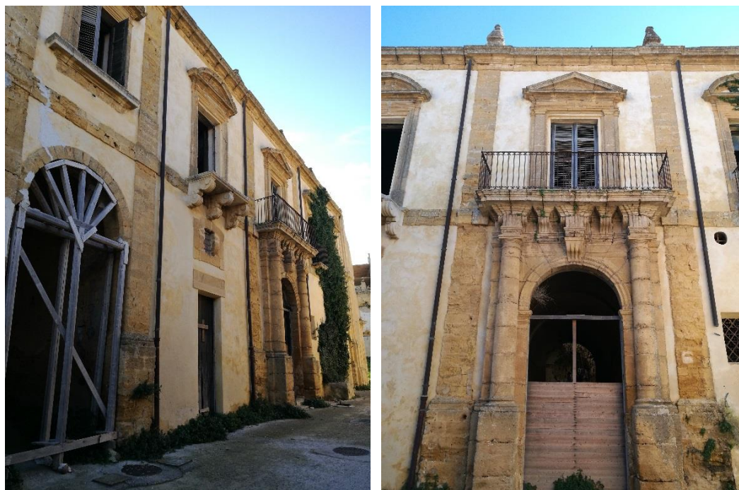
Figura 2.33 - Santa Margherita di Belice. Ruedi su via Collegio. Palazzo Scaminaci. Sul retro della Palazzata si individua il tessuto storico della città ridotto a rudere nel quale è possibile riconoscere esempi di architettura di pregio sottoposti a tutela e messi in sicurezza in attesa di interventi di restauro che ne consentano la valorizzazione. Fonte: Foto dell'autrice, 2017.
