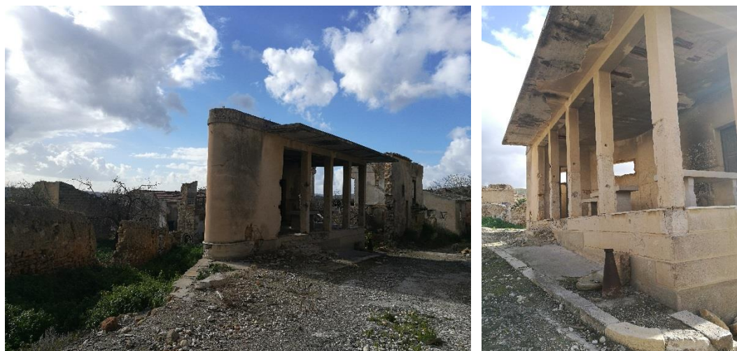
Figura 2.17 – Ruedi di Poggioreale. Le strutture realizzate con tecniche moderne e ossatura portante di cemento armato hanno riportato solo lievi danni senza subire notevoli crolli. Fonte: Foto dell'autrice, 2017.
