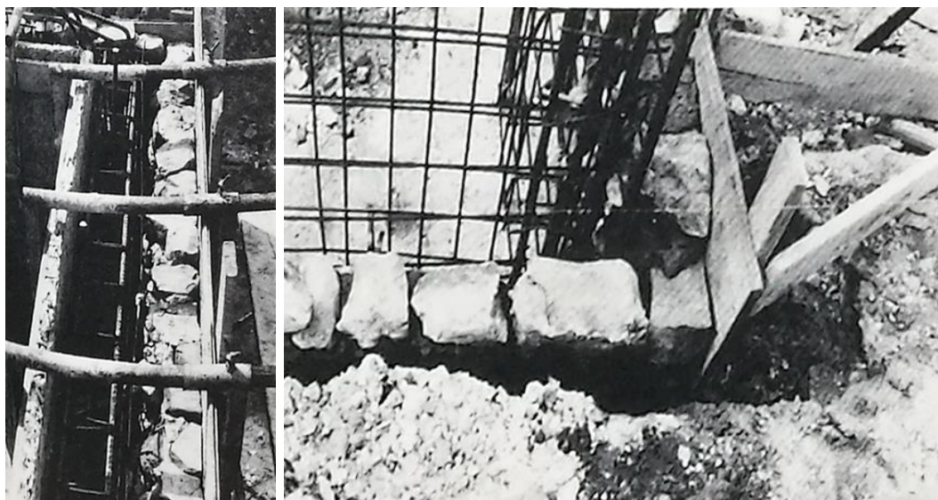
Figura 2.162 - Venzone. “Cassero del Gruagno”. La ricostruzione fu occasione di sperimentazione di nuove tecniche che consentirono di ricostruire murature di pietra integrate nel calcestruzzo armato attraverso un cassero studiato ad hoc. Fonte: Ricostruire, agosto 1977, 66-67.
