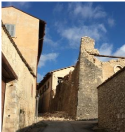
N. 22 Collapsed church (2)
