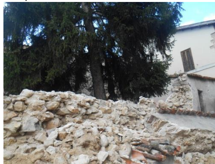
N. 8 Collapsed wall
