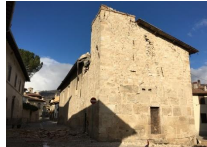
N. 21 Collapsed church (1)
