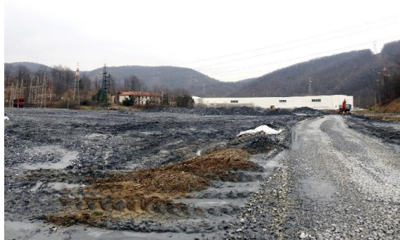
Figura 65 - Sito in preparazione per un nuovo insediamento industriale a Cairo Montenotte (Savona). Foto di Gianni Ciarlo.
