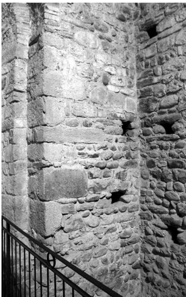
Fig. 4. Torre campanaria. Vista della muratura nell'angolo sud-est in corrispondenza dell'abside in spessore di muro.
