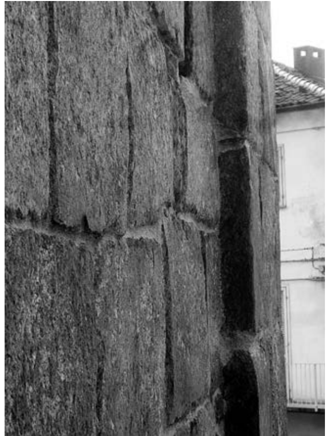
Fig. 9. Torre campanaria, lato nord. Tracce di lavorazione a cunei in corrispondenza del giunto orizzontale del secondo livello.
