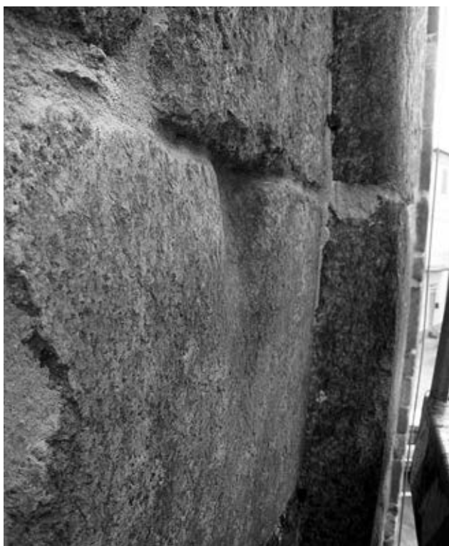
Fig. 2. Torre campanaria, lato nord. Basolo usurato dal passaggio di carri riquadrato come concio posto al secondo livello.
