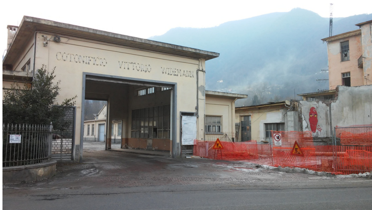
Figura 15. Cotonificio Widemann, dicembre 2016: lavori in corso per la creazione della nuova centrale idroelettrica (foto: Rudiero).
