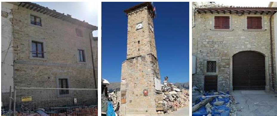
Figura 1 - Amatrice (Rieti): muratura in pietrame di un ex Convento; torre civica; casa in muratura in pietrame, sostanzialmente intatta - Amatrice (Rieti): Basically intact natural stone masonry buildings after the earthquake (magnitude 6.2 \pm 0.016 Mw) in 2016: a-former monastery; civic tower; private home.
