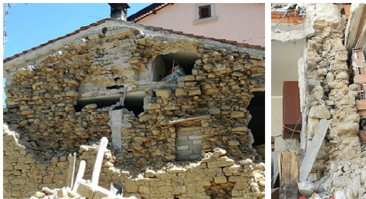
Figura 5 - Esempi di muratura in pietrame a doppio paramento priva di malta e scollegata - Examples of double layer stone masonry with lack of mortar and poorly connected.
