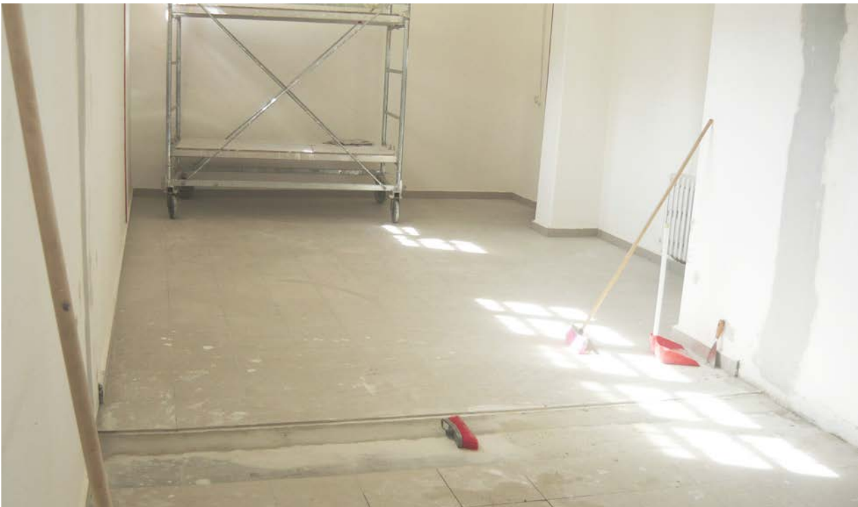
Il muro che separava le due aule è stato demolito a formare il locale che ospiterà la biblioteca.
