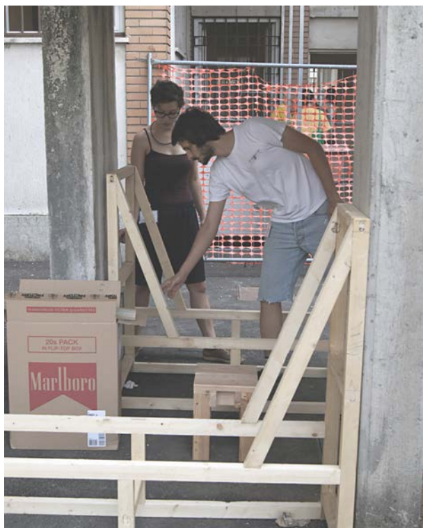
52. Nell'area 2 si posano i telai in legno prodotti nei laboratori del Plana che ora dovranno essere rivestiti.
