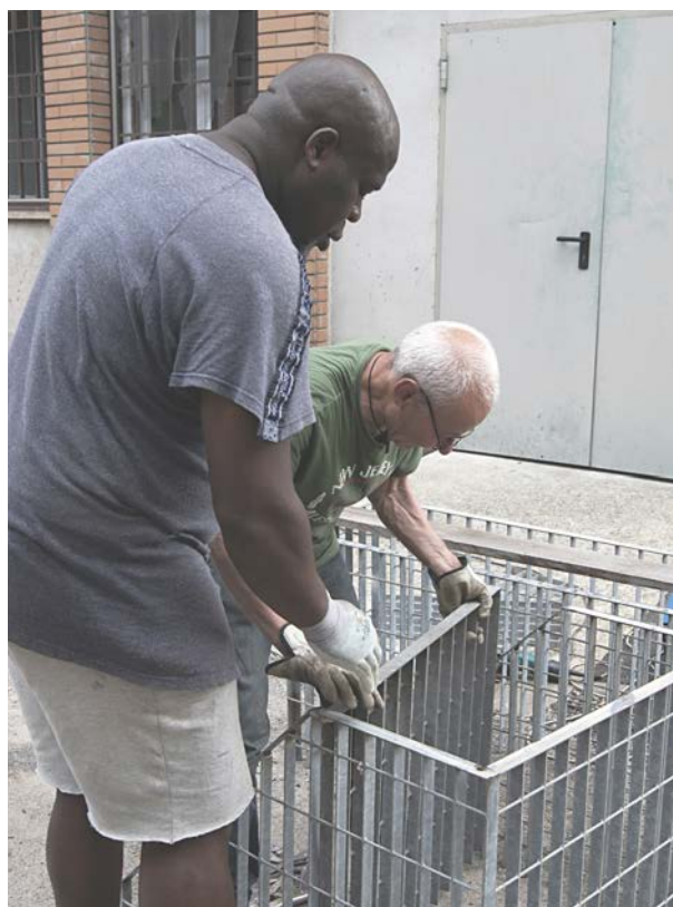
31. Le prime scatole in orso-gril sono pronte, costituiranno la base delle panche dell'area 1.
