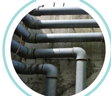
tubi idraulici (pergolati)
