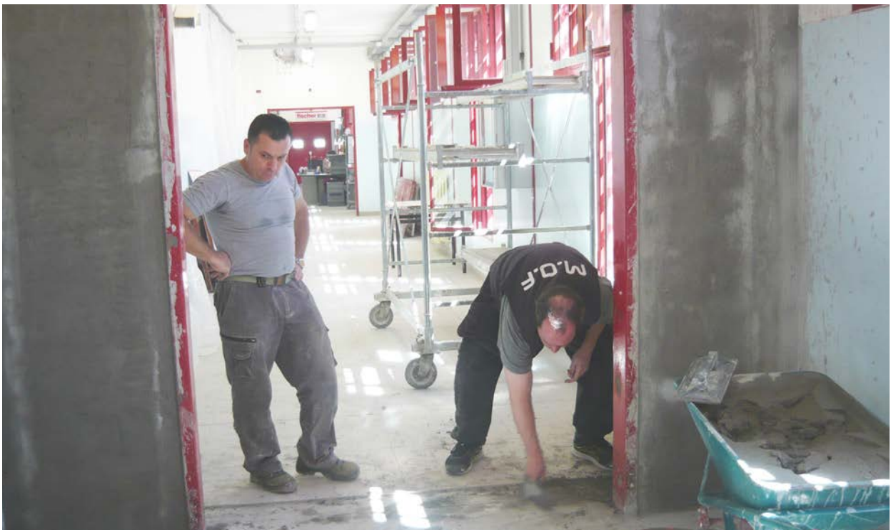
Il telaio della porta nella nuova posizione è posato, la MOF procede con le finiture.
