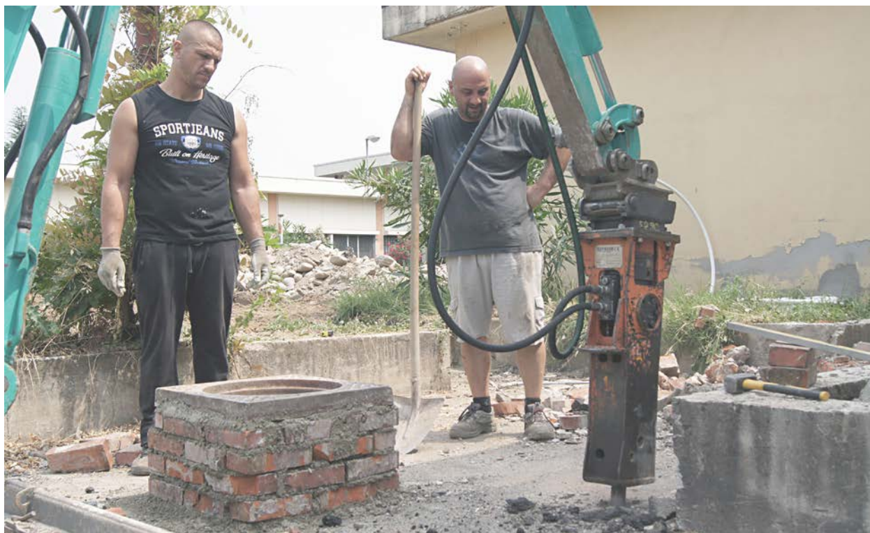
26. Il nuovo pozzetto è pronto, si rompe l'asfalto nelle zone in cui saranno posati i nuovi cordoli.
