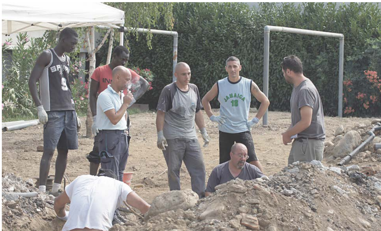
54. Nell'Area 1 il problema dello scarico intasato ha visto quasi tutto il gruppo MOF all'opera insieme.
