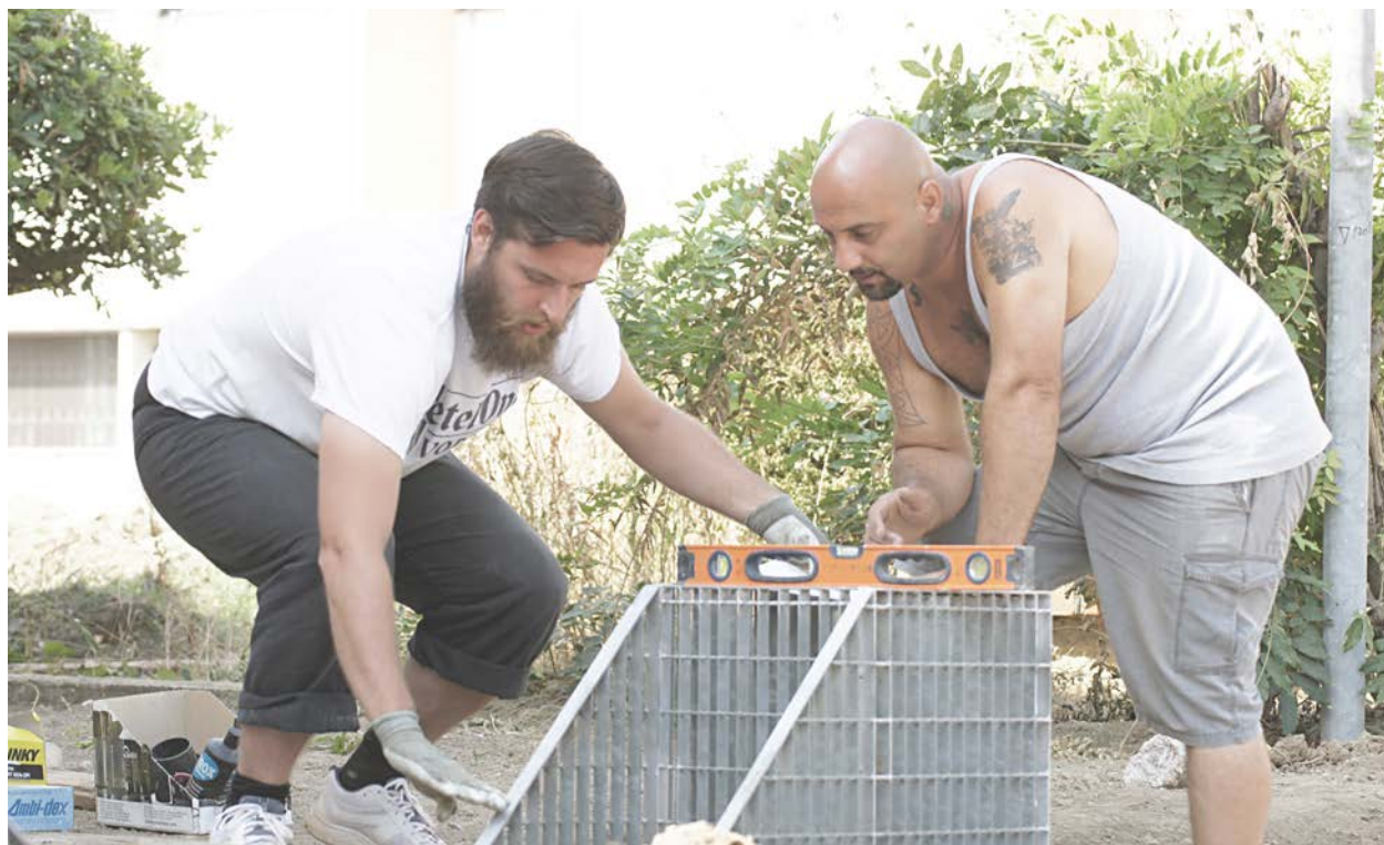
57. Ora i telai devono essere saldati ai ferri di armatura della soletta in cemento, posizionarli in bolla è una vera impresa.
