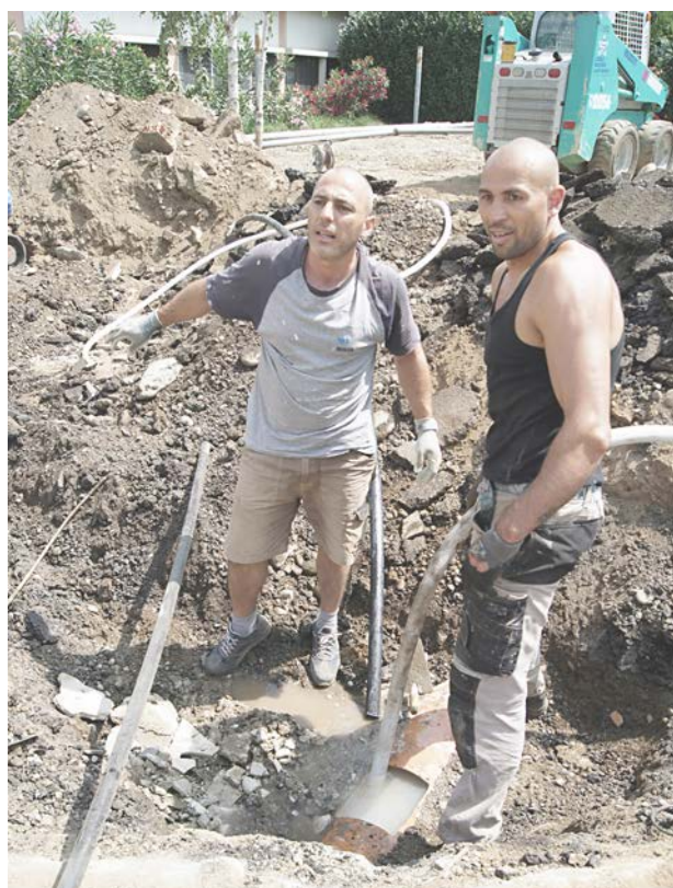
38. Nell'area 1 l'impianto di scarico delle acque reflue è intasato, servirà chiamare il servizio di spurgo.
