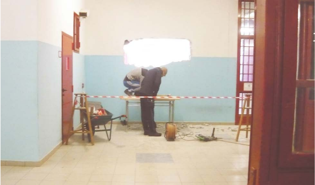
I lavori sono cominciati con le demolizioni per la nuova biblioteca, qui l'apertura della porta.
