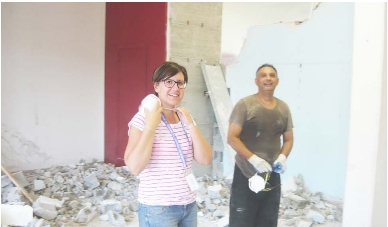
Valentina controlla e coordina i lavori di demolizione, che richiedono particolare attenzione ai criteri di sicurezza.
