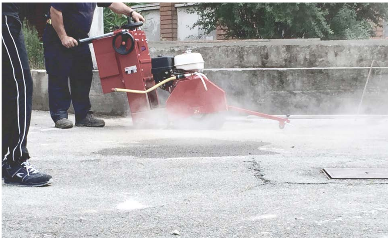
7. Il taglio dell'asfalto, per ottenere le aree verdi previste dal progetto. La disponibilità del macchinario è stata sfruttata anche per realizzare le tracce per gli impianti di una piccola armeria di recente costruzione in prossimità dell'ingresso.
