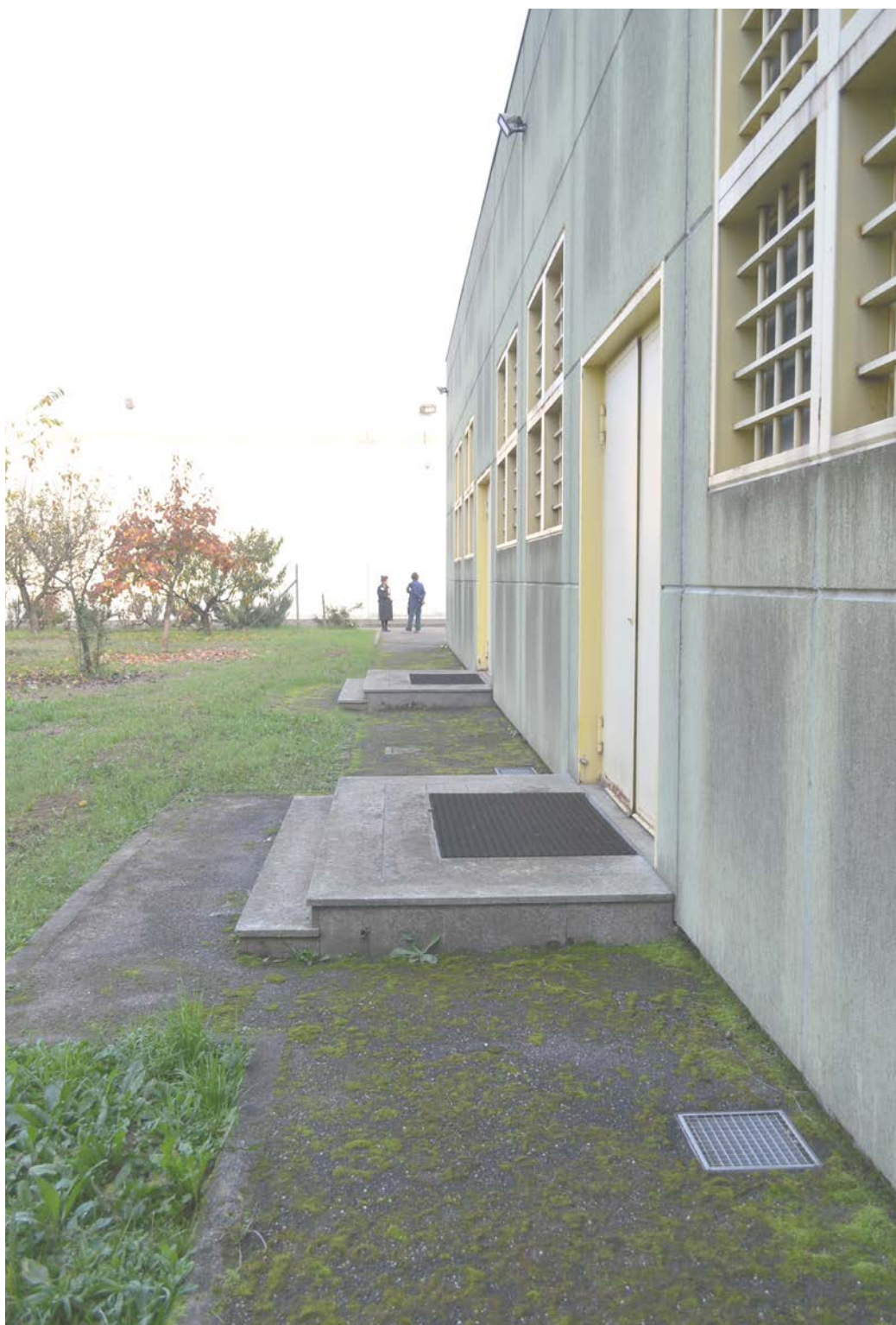
Lungo la facciata laterale dell'edificio del teatro nell'area detentiva della C.R. San Michele, Alessandria.
