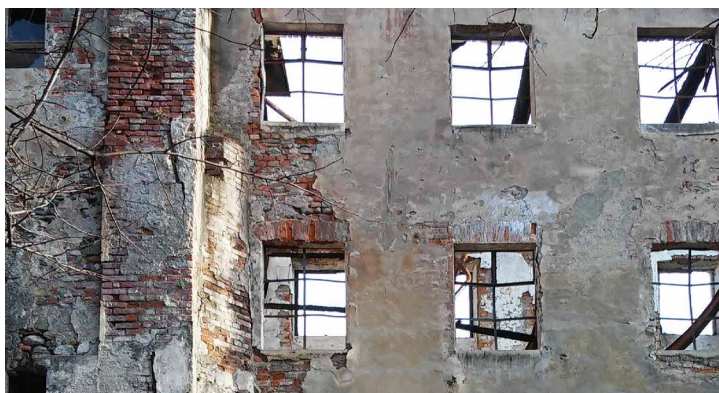
Fig. 20 Danni da fuoco alle pareti, all'orditura della copertura e alle travi metalliche che sostenevano i solai lignei d'interpiano del Follone di Pinerolo (foto: R. Rudiero)
