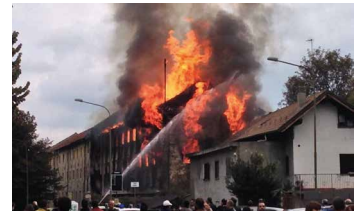
Fig. 4 Pinerolo (TO). Lavori di abbattimento del complesso della Fabbrica Elettrodi della Società Talco Grafite Val Chisone (foto: M. Calliero)
