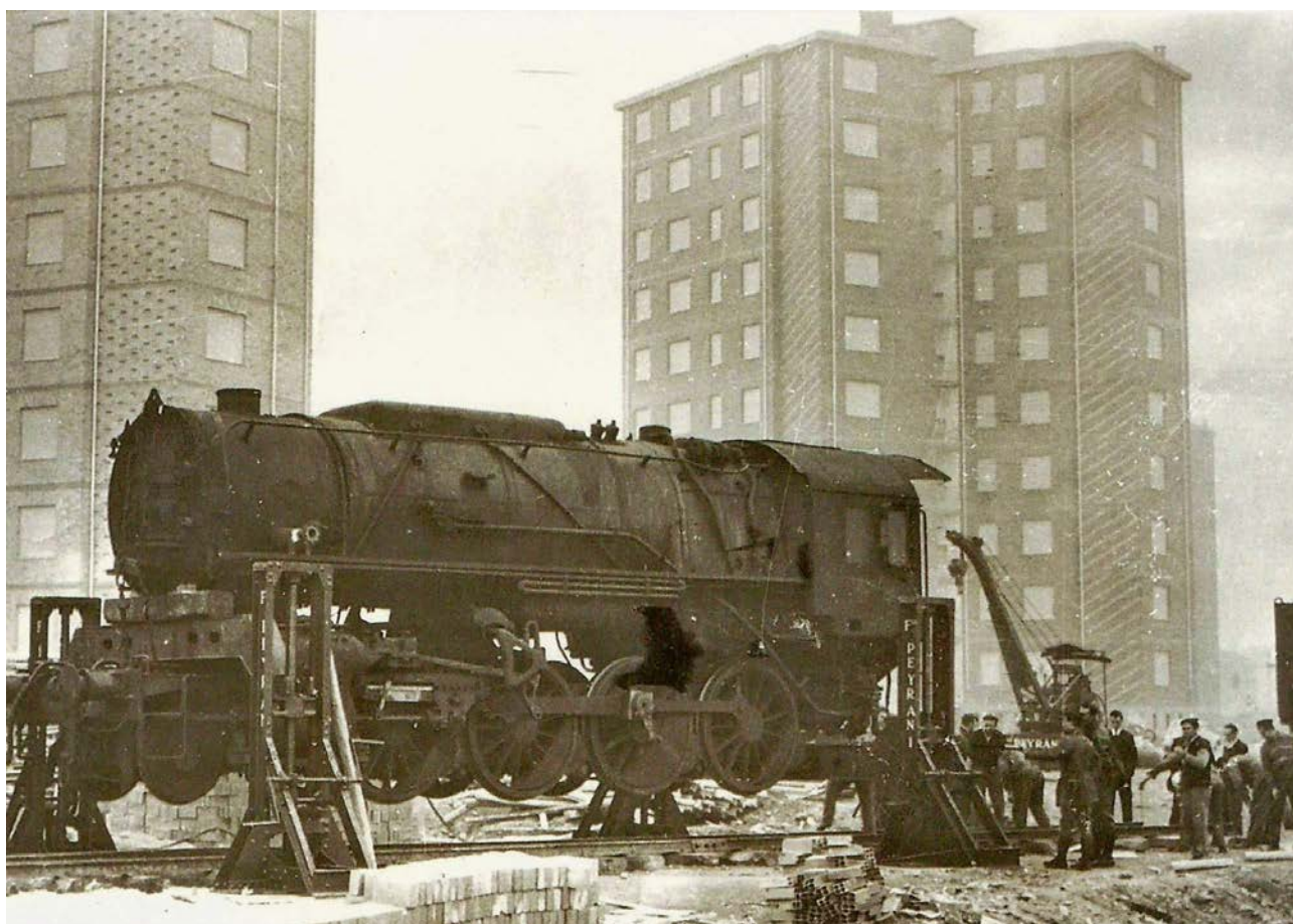
4.5 Quartiere C.E.P. Le Vallette, 1961. La locomotiva utilizzata come caldaia per il riscaldamento. Sullo sfondo le torri del settore C progettate dal gruppo dell'ingegnere Giorgio Rigotti, affacciate sulla via delle Primule. (Archivio Storico delle Città di Torino, Fondo Gazzetta del Popolo )
